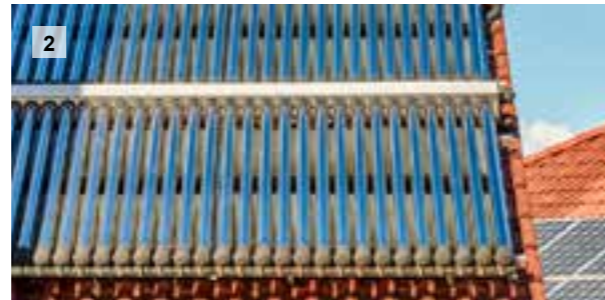
Abb. 2: Bsp. Solathermieanlage als Vakuumröhrenkollektor (Quelle: Adobe Stock / reimax16)
