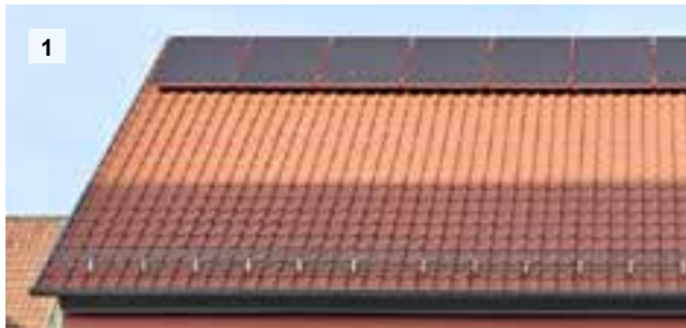
Abb. 1: Bsp. Positivbeispiel: Photovoltaikanlage in Münsterstadt, Manggasse 14 (Foto: Francesco von Rhein)
